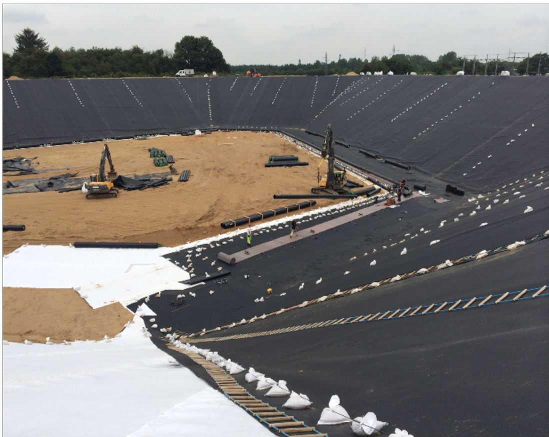
Foto: Damvarmelager, Planenergi
